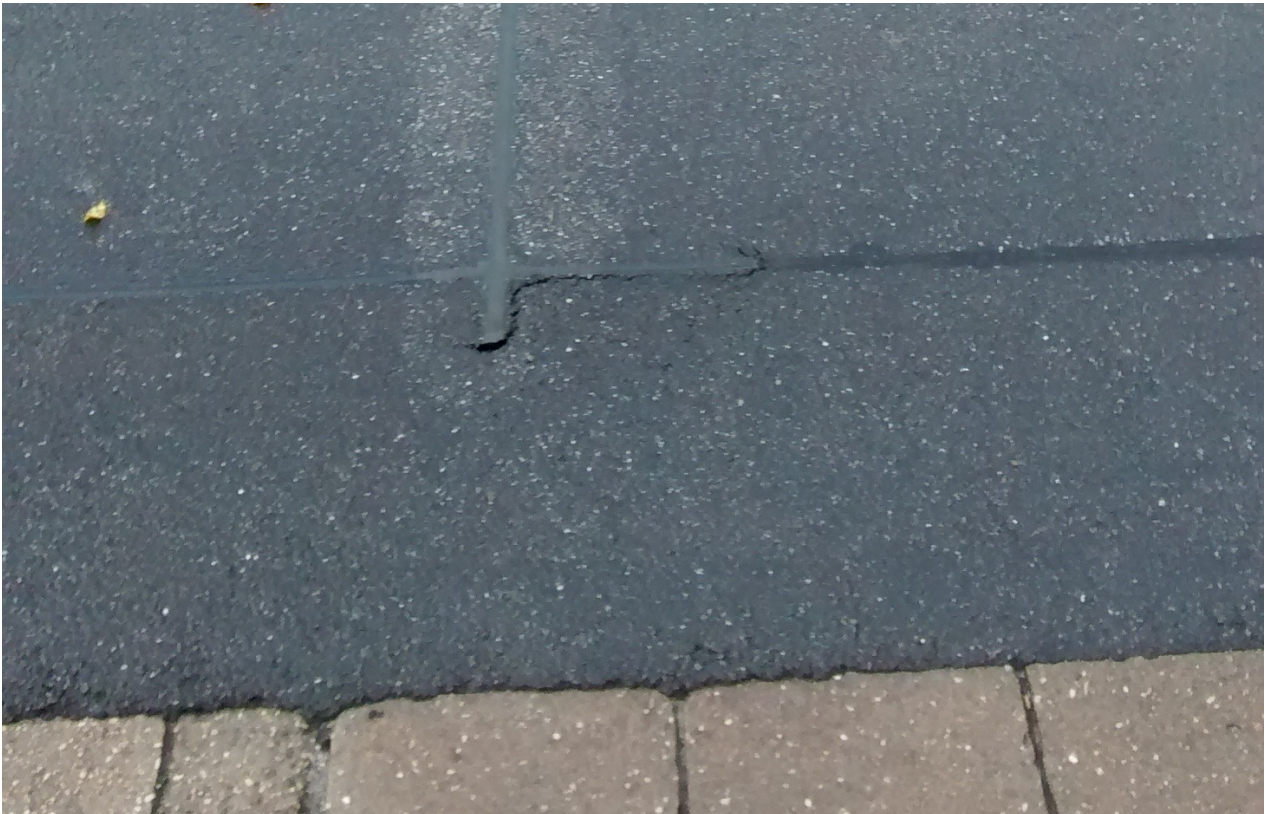
Abbildung 8: gleiche Messstelle, erkennbare Risse, Quelle: VUT Messstellendatenbank, Aufnahme 06.10.2015
