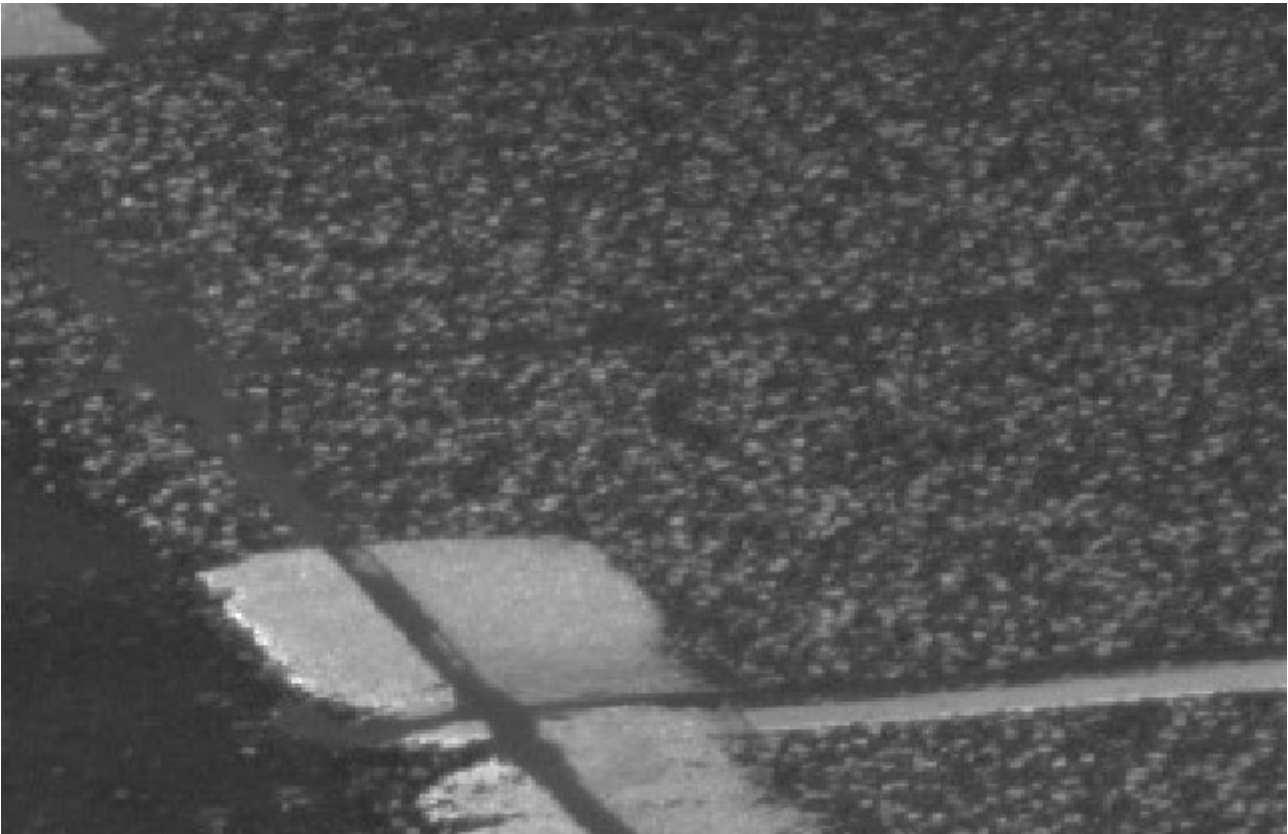
Abbildung 6: Ausschnittvergrößerung aus Abbildung 5 mit erkennbaren Rissen und Verwerfungen an der Fahrbahnmarkierung
