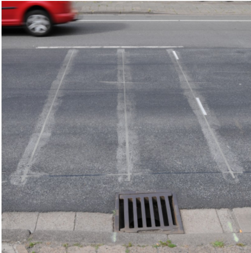
Abbildung 7: Messstelle Saarlouis, Saarbrücker Straße, Gullydeckel zu nahe an Sensorik, Quelle: VUT Messstellendatenbank, Aufnahme in 2014
